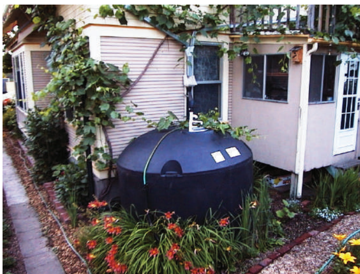
تصویر (۲) مخازن پیشرفته برای جمع‌آوری آب باران از روی سطح بام ساختمان مسکونی
